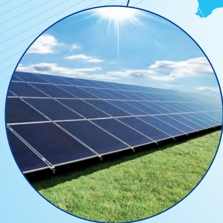
Solar Power Plant 太阳能发电站
