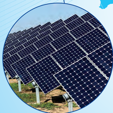
Solar Power Plant 太阳能发电站
