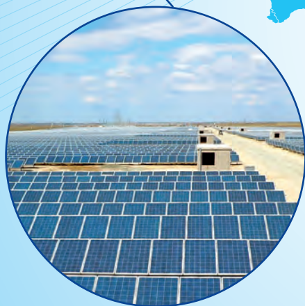
Solar Power Plant 太阳能发电站
