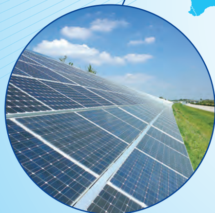
Solar Power Plant 太阳能发电站
