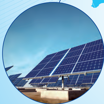
Solar Power Plant 太阳能发电站
