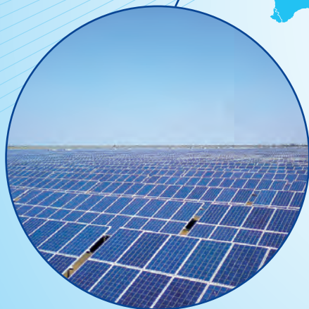
Solar Power Plant 太阳能发电站
